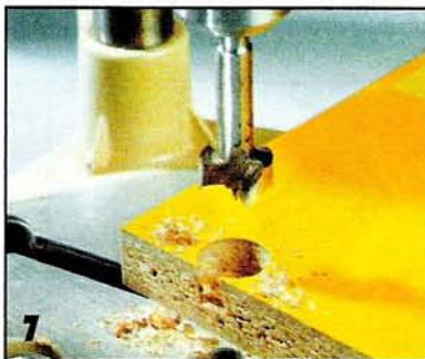
7 Стяжку сажают в отверстие, находящееся так близко от края плиты, что оно сбоку прорывается. Сверлят отверстие точно по шаблону.
