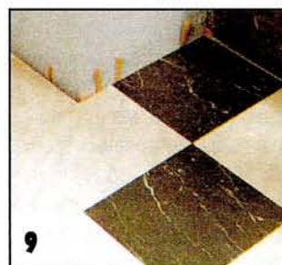
9 Подгонка последующего ряда элементов к косяку дверной коробки. Швы между полом и дверной коробкой заделывают эластичным герметиком.
