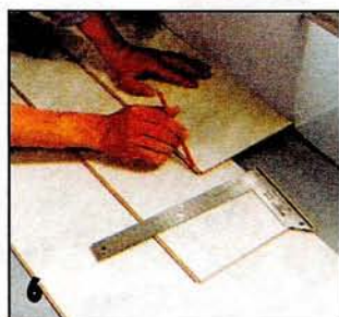
6 С помощью мерной доски и карандаша размечают вырез на доске, например, под выступающую дверную коробку.
